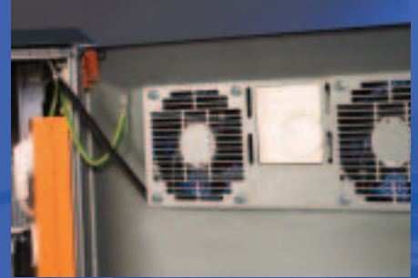
Distribution électrique et ventilation
