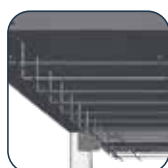
Gestion horizontale des câbles
